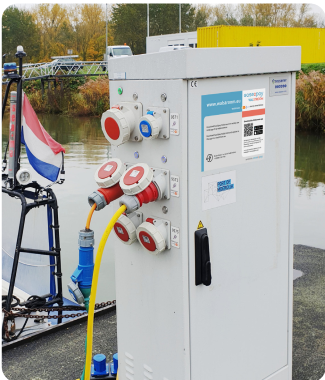
Walstroomkast bij Port of Moerdijk
